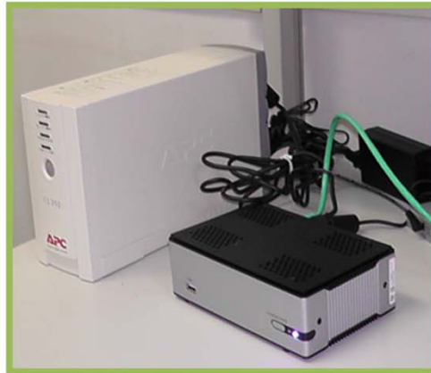
広域観測ネットワーク監視システムのデータ送信サーバとUPS (パッケージ化されています)。
