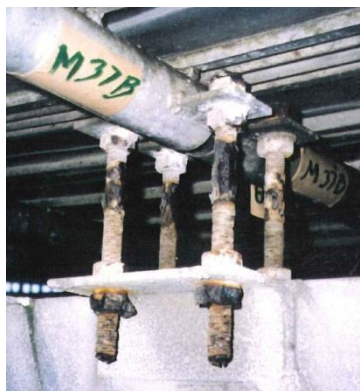
写真-17 アンテナ主反射鏡パネル(上部)を固定するボルトは、腐食が進み、切断一步手前のものもあった
