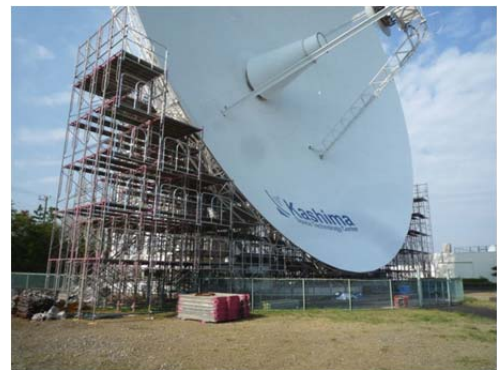
図 10: 鹿島 34m 背面構造部の補修塗装(4 月～5 月) アンテナ傾斜時に地上に近づく箇所に足場を仮設、下側の三分の一程度の補修塗装を実施した。毎日の作業終了後には強風に備えてアンテナを天頂へ戻した。
