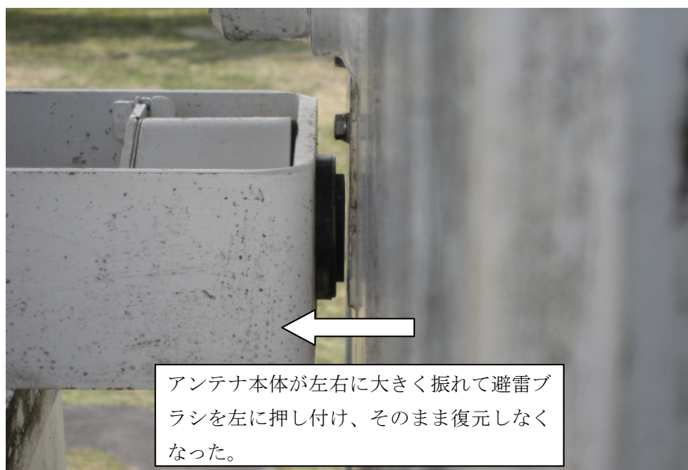
写真7 V L B I 10mアンテナのエレベーション避雷ブラシ レールとの間に隙間が生じてしまっておりレールと接触していない
