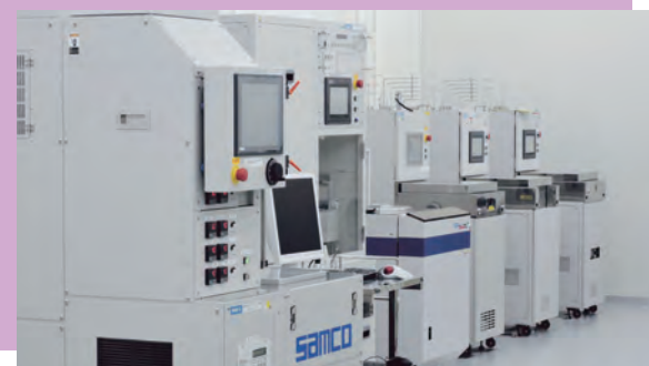
神戸クリーンルーム内装置
