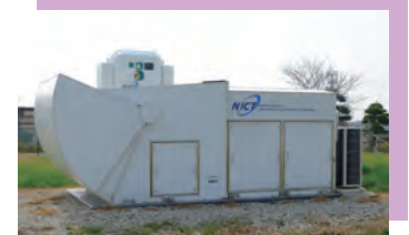
空間通信設備小型光地上局の全景
