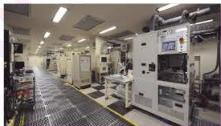
クリーンルーム内のプロセス装置
