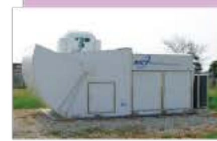
空間通信設備小型光地上局の全景
