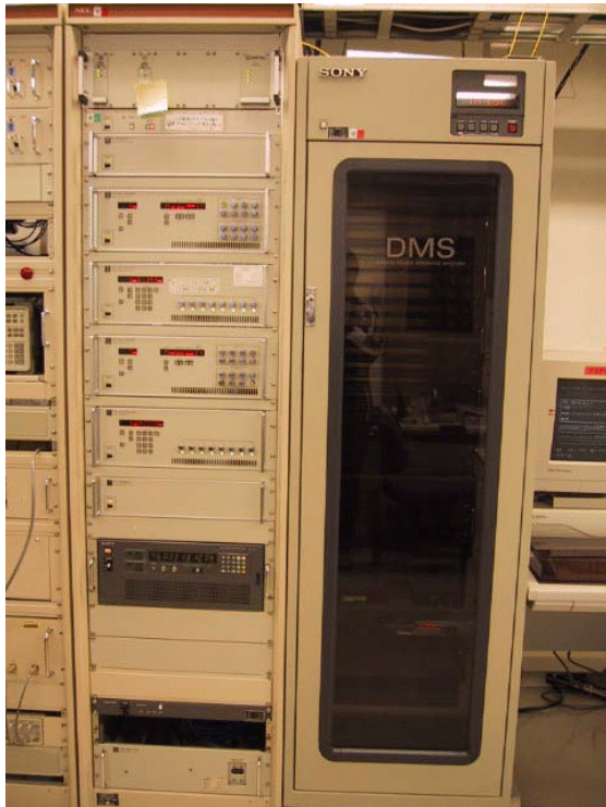
図 15: K4/KSP システム。左側に局部発振器、ビデオコンバータ、AD サンプラがあり、右側は自動テープ交換ロボットである。
