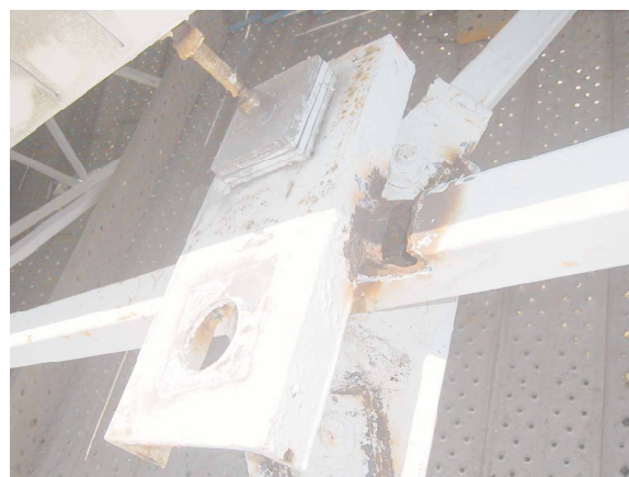
図 27: 主鏡パネルをはずして上側から見た典型的な腐食部分の例
