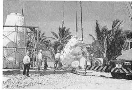
第19図 10メートルアンテナの同部の組立
