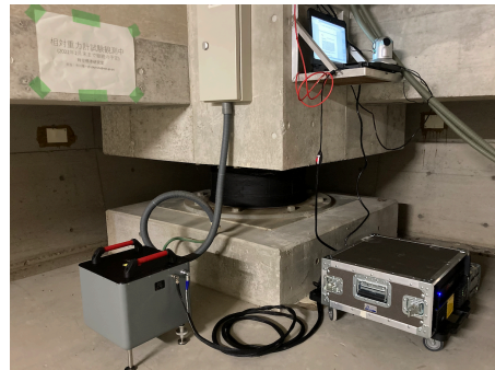
図5 光格子時計の設置されている2号館の地下室に設置されている相対重力計gPhoneX
